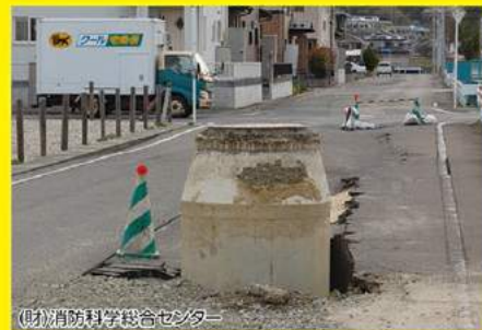
液状化によって浮きあがった マンホール(宮城県白石市)
