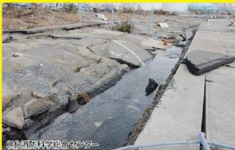
(財)消防科学総合センター 決壊した河川護岸(宮城県仙台市)
