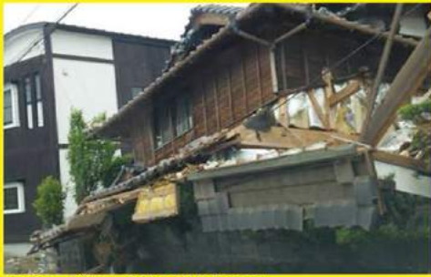
倒壊し、ブロック塀も崩れた家屋 (熊本県上益城郡益城町)
